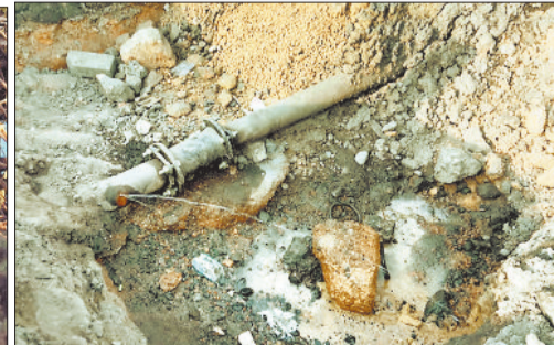
इस तरह टूटा पाईप लाइन।
